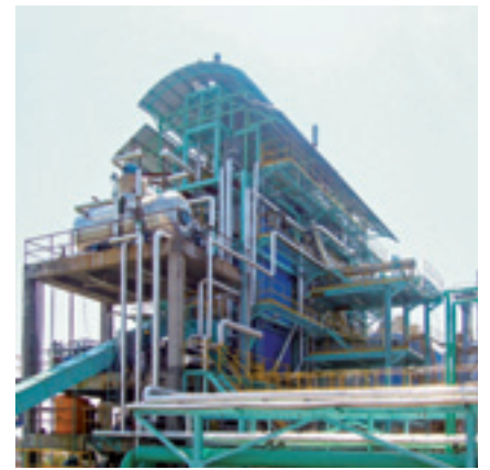
インドネシアの建材製造会社であるRPI社の木質バイオマスボイラー
